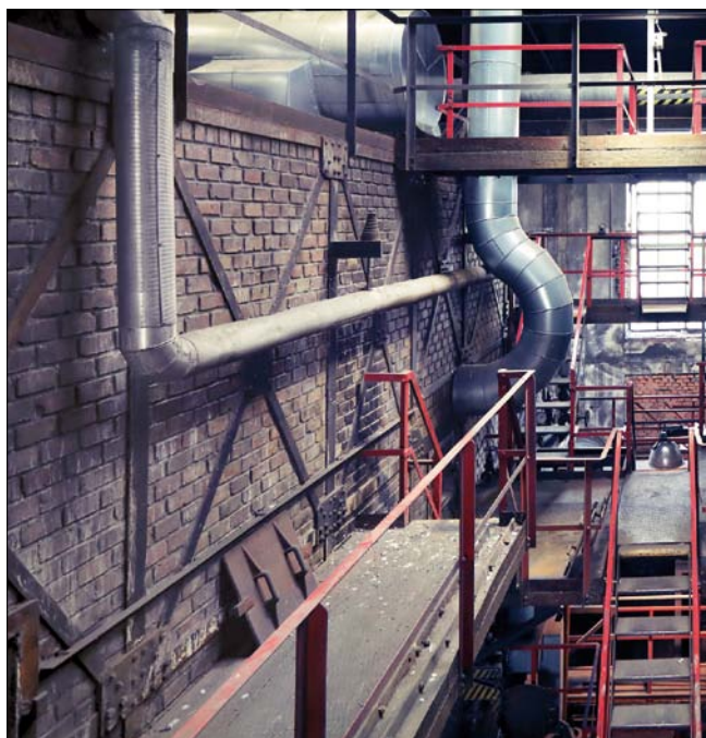
Obr. 3. Ze staré uhelné kotelny
