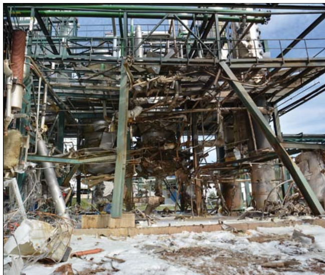
Obr. 2. Dobrovický lihovar poškozený explozí (22. 9. 2015)
