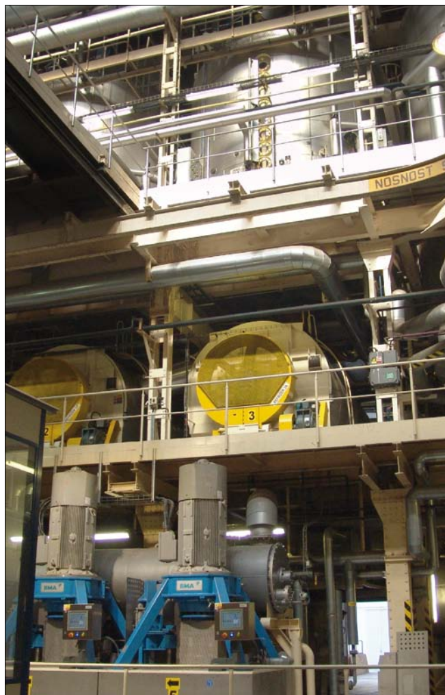
Obr. 2. Varna cukrovaru: na horním podlaží jsou zrnice, uprostřed jsou krystalizátory a pod nimi odstředivky
