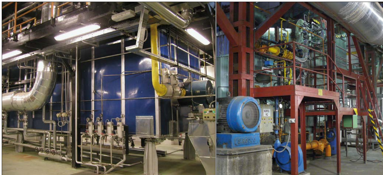
Obr. 3. Tepelně energetická centrála: parní kotel (3)
