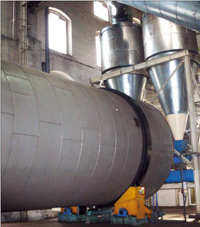
Obr. 2. Bubnová sušárna řízků (3)
