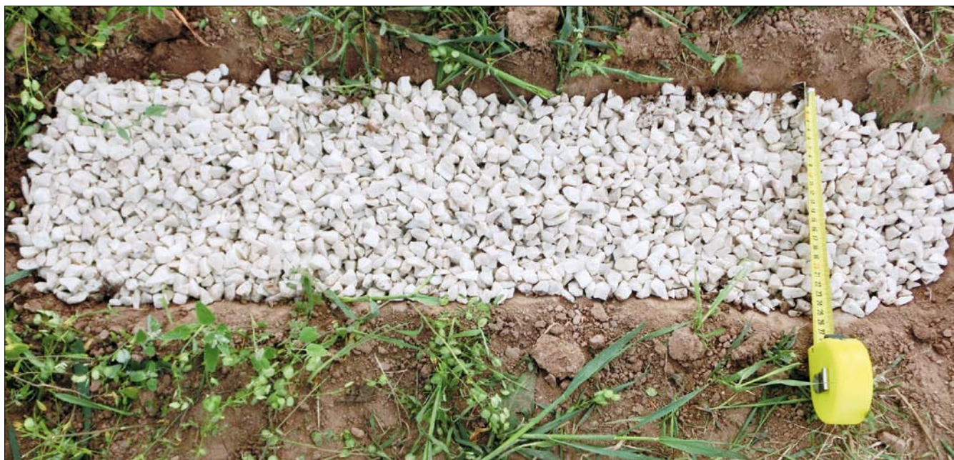
Obr. 9. Drť vápence v rýhách kolmo na směr následného přejezdu strojů na zpracování půdy
