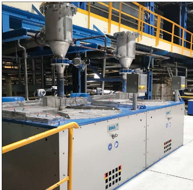
Obr. 6. Instalace kontinuálních odstředivek B produktu v Opavě v rámci projektu OPPIK – Energetické úspory v Moravskoslezských cukrovarech, s.r.o. – realizace v roce 2021
