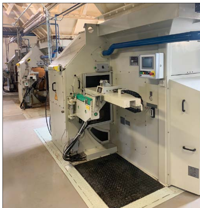
Obr. 3. Realizace OPPIK – Energetické úspory ve společnosti Tereos TTD, a. s. – řezačka řepy Dobrovice
