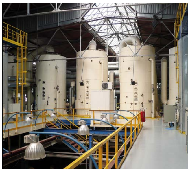
Odpařovací stanice – část pětistupňové odparky v cukrovaru Opava
