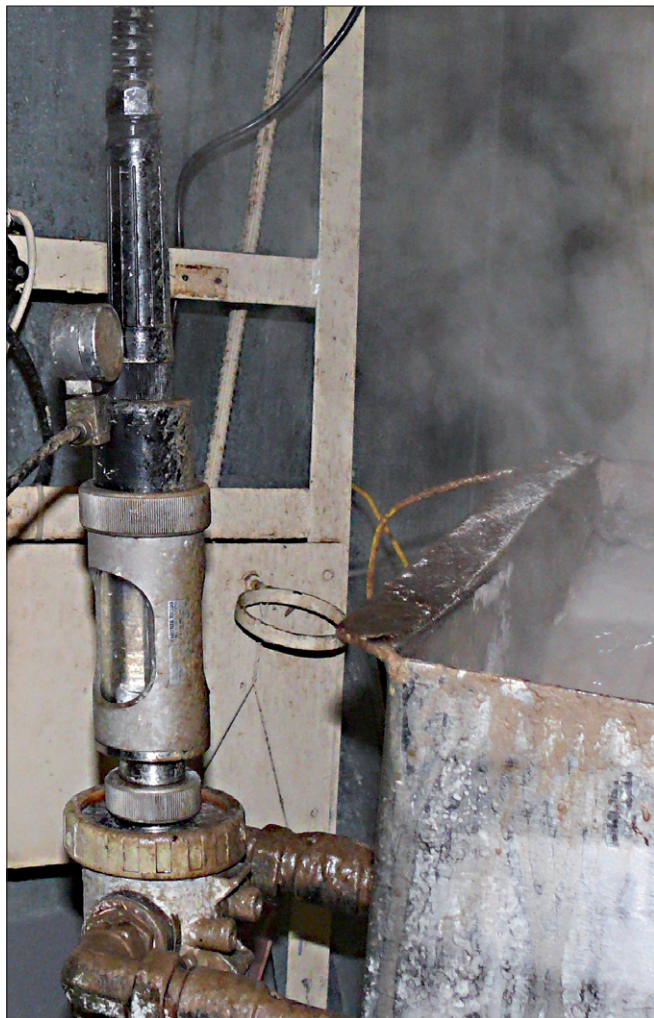
Obr. 5. Snímač pH Mettler Toledo instalovaný do obtoku provozní aparatury (foto M Kmínek)
