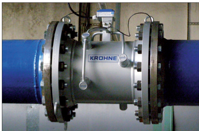
Obr. 4. Ultrazvukový průtokoměr Krohne UFM 3030 v potrubí při měření tepla
