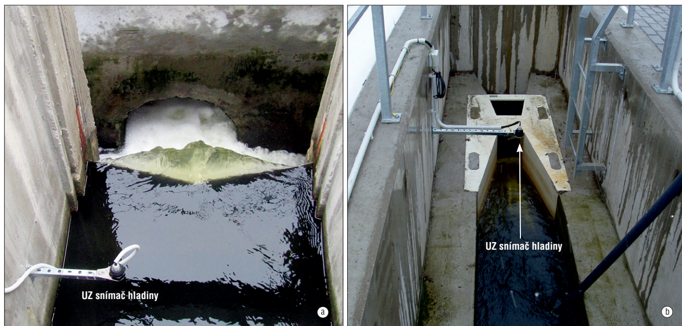
Obr. 4. Měřicí zařízení na odtocích z čistírny odpadních vod: a) trojúhelníkový přepad, b) Parshallův žlab
