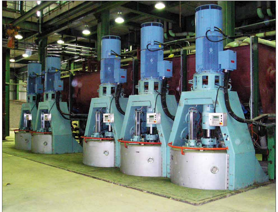
Obr. 2. Baterie odstředivek ARO 90-1600
