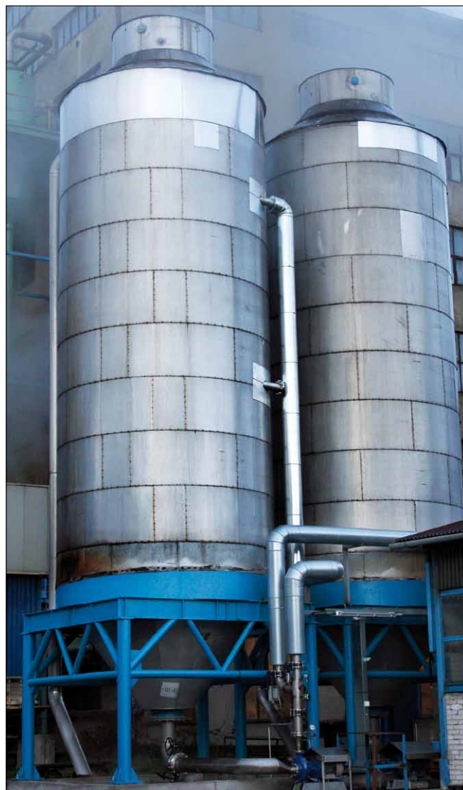
Obr. 3. Nádrž kondenzátu a regenerátu umístěné vně budovy
