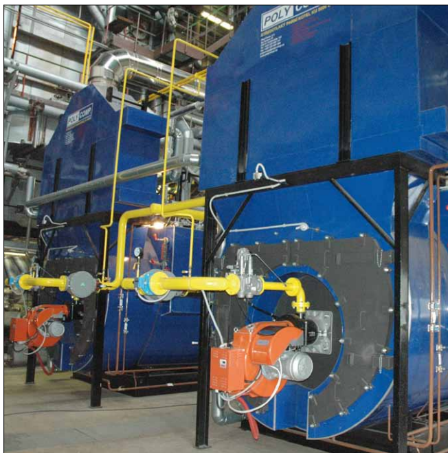
Obr. 4. Nové kotle KU 5000 E
