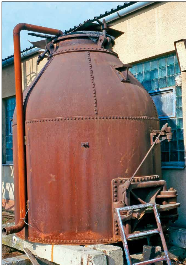
Obr. 2. Nádrž na krmnou melasu se vstupním horním otvorem zabezpečeným proti vniknutí ptáků
