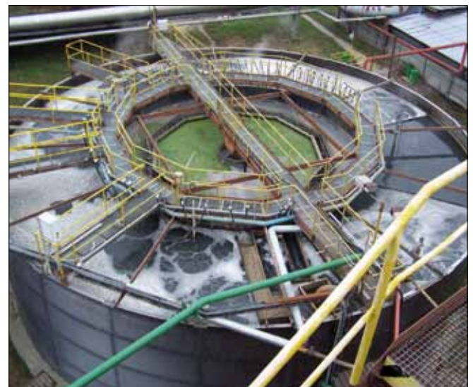
Obr. 6. Aeróbná nádrž čističky cukrovare Sereď
