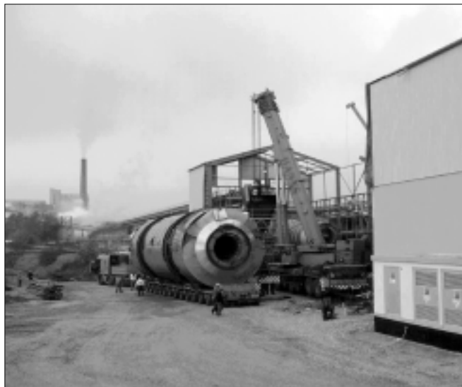
Obr. 5. Instalace sušárny řízků v cukrovaru České Meziříčí
