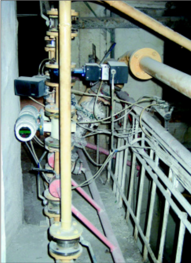
Obr. 5. Rozdelenie vápenného mlieka z tlakového kolektoru
